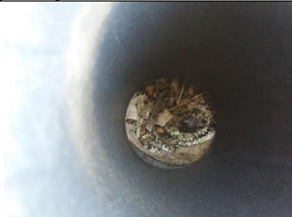
Foto nr. 11. Katuse tuulutamise diflektoritesse kogunenud praht.
