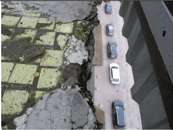
Foto nr. 15. Paneel laguneb, seda on püütud seguga parandada.
