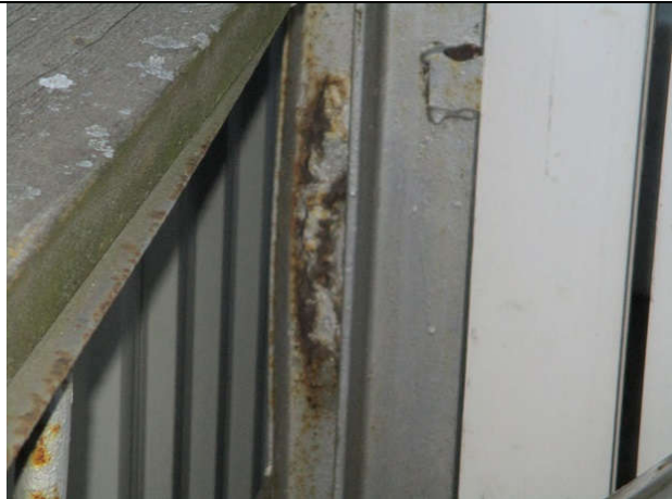
Foto nr. 3. Korrodeerunud koht on kaetud värviga, eelnevalt roostet eemaldamata.
