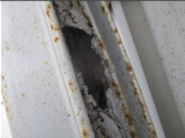
Foto nr. 1. Põrand koorub, armatuur on väljas ja korrodeerub.
