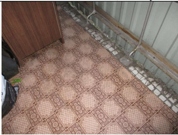
Foto nr. 24. Põrandal on linoleum, lodža asju täis.
