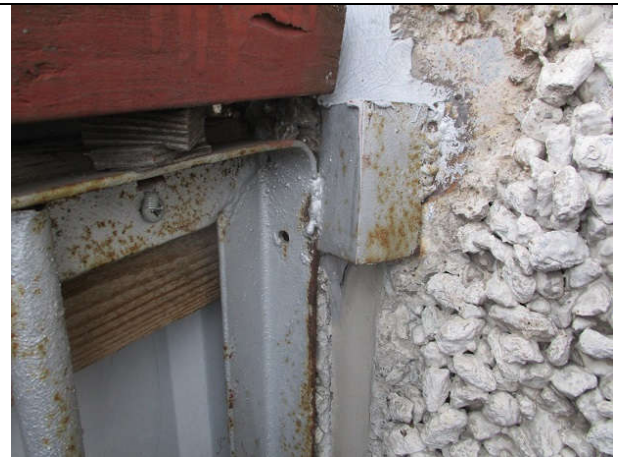
Foto nr. 5. Korrodeerunud koht on kaetud värviga, eelnevalt roostet eemaldamata.
