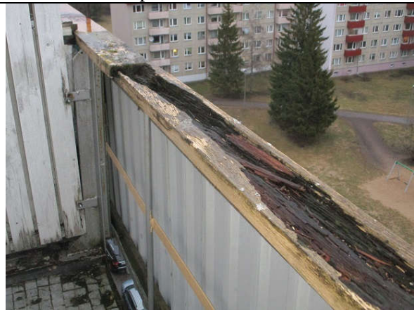
Foto nr. 23. Piirdepuut on amortiseerunud.
